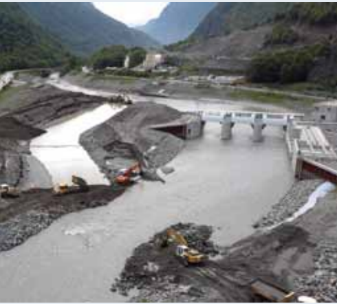
L'aménagement de Romanche-Gavet en Isère : c'est le plus grand projet hydroélectrique en cours de réalisation en France qui consiste à remplacer six centrales par une seule usine souterraine, plus performante et mieux intégrée à son environnement avec une galerie de plus de 9 km creusée dans le massif de Belledonne. La mise en service est prévue en 2017.
